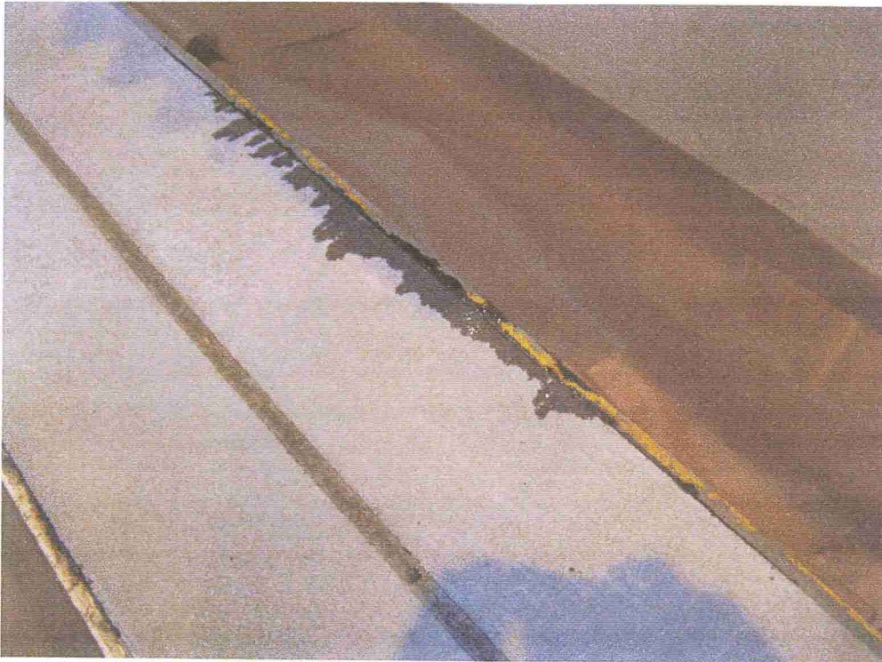
Bild 5 Gelaustritt im Schlauchabschnitt 15 - 30 m
